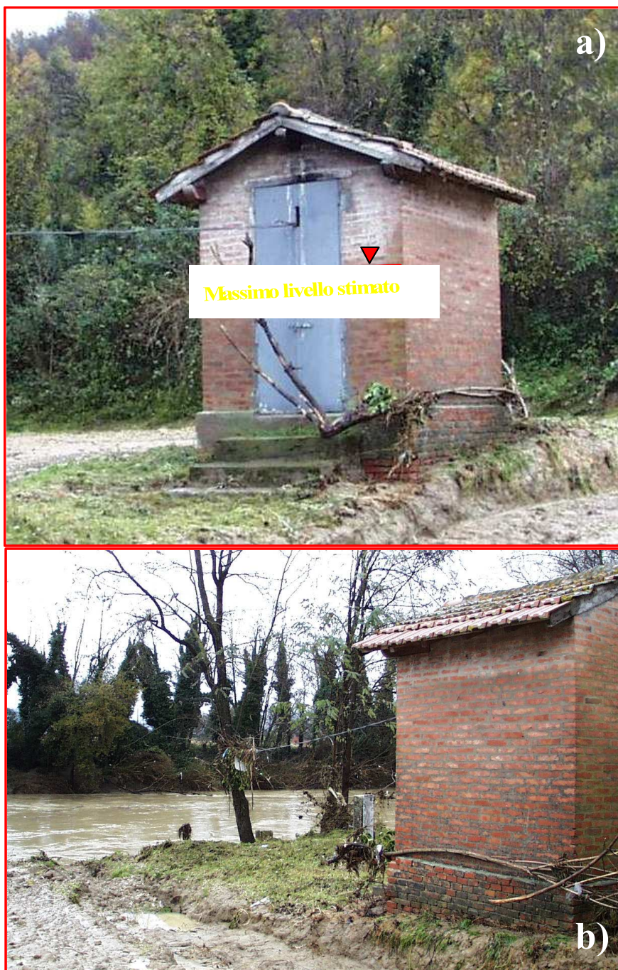
Figura 9. Sezione Ponte Felcino - teleferica: evidenze lasciate dall'acqua esondata sulla cabina durante l'evento del Novembre 2005.
